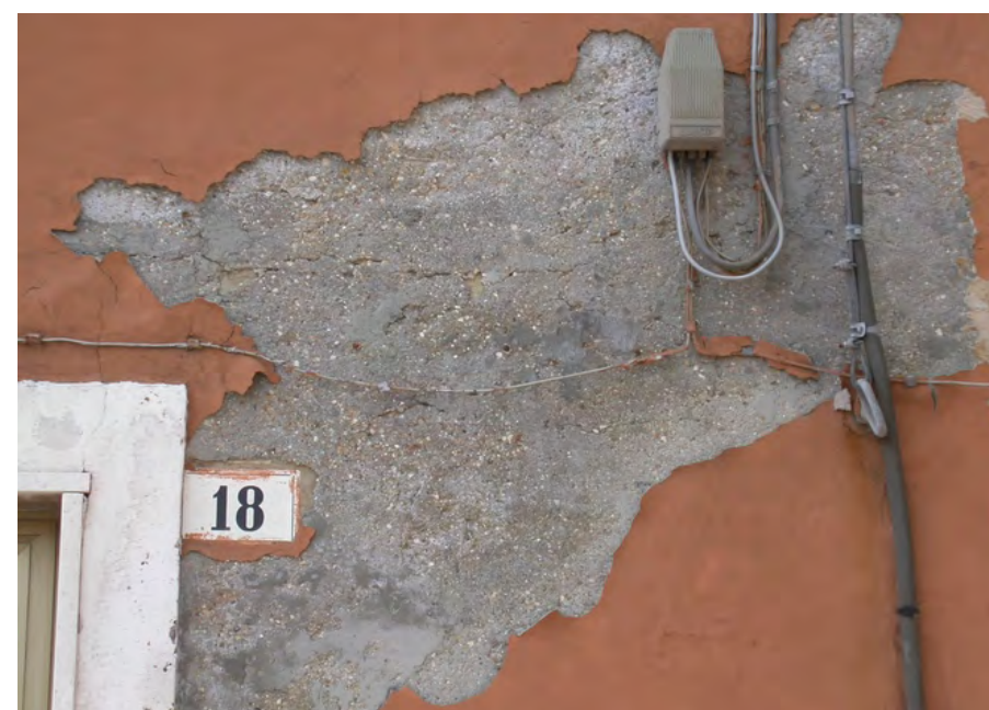
3_tinteggio: caduta e distacco per incompatibilità del supporto in intonaco di cemento
