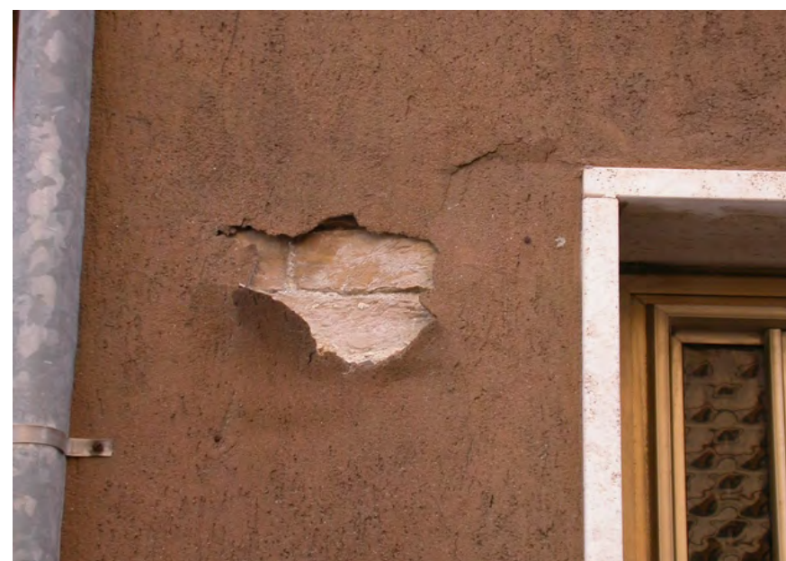
3_ Il Tinteggio al quarzo è incompatibile con il supporto murario di mattoni
