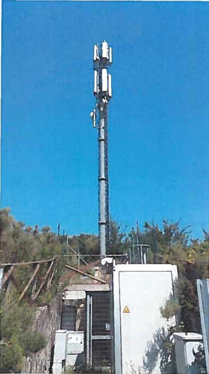
Foto 1 – Struttura porta-antenne su cui sono installate le antenne delle S.R.B.
