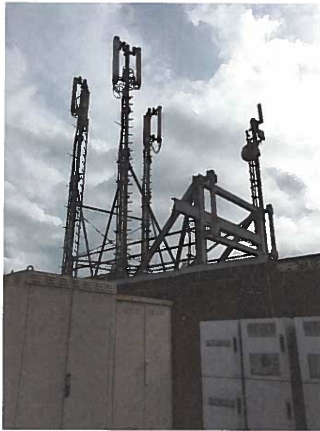
Foto 1 - Area su cui è installata la S.R.B.
