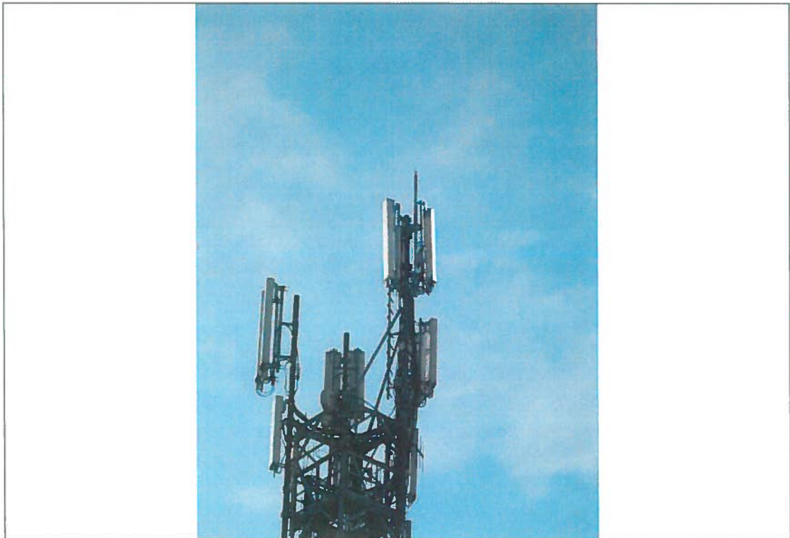
Vista della SRB (sistema radiante) - punto di vista 3
