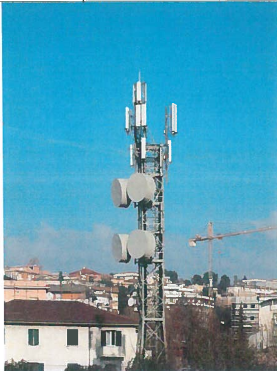
Vista d'insieme della SRB esistente - punto di vista 2
