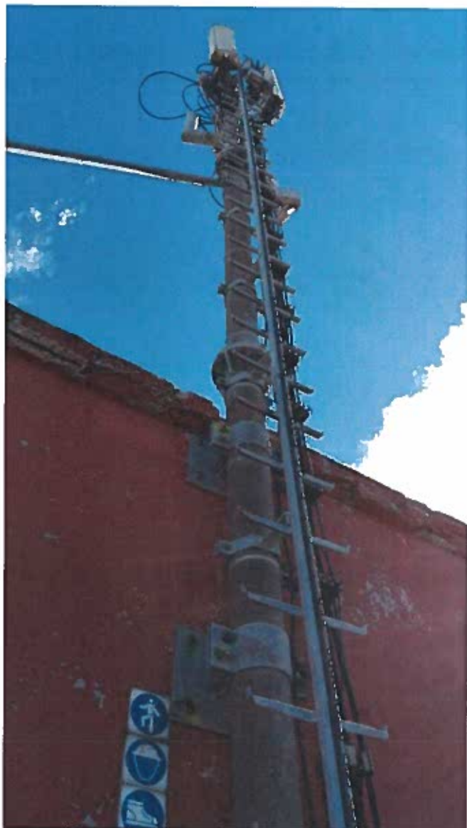
Foto 1 – Area su cui è installata la SRB.
