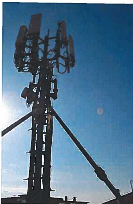
Foto 2 – Area su cui è installata la SRB.
