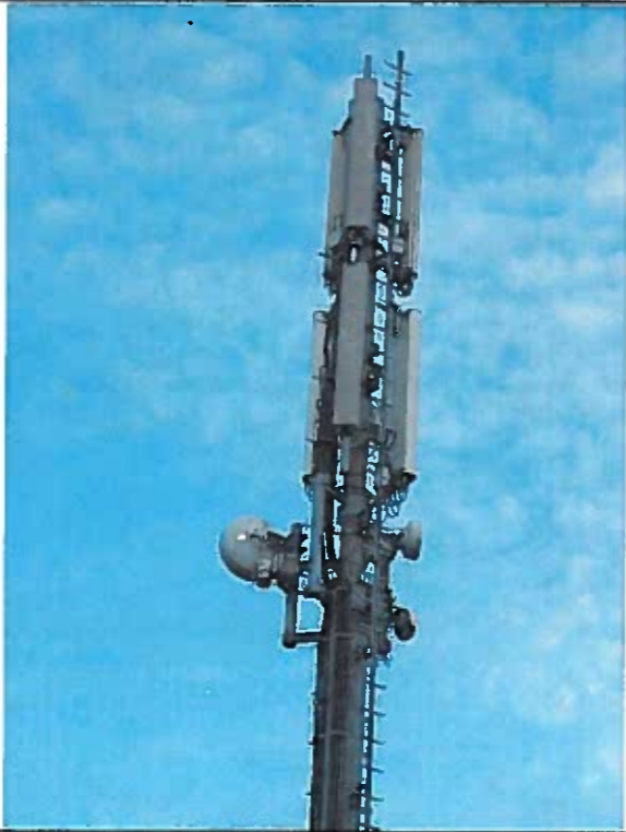
Foto 2 – Impianto (Dettaglio Sistema Radiante)
