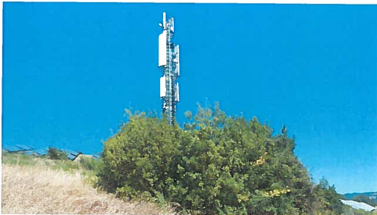
Foto 1 - Area su cui è installata la S.R.B.
