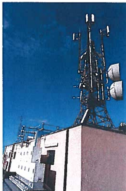
Foto 4 – Area su cui è installata la SRB.
