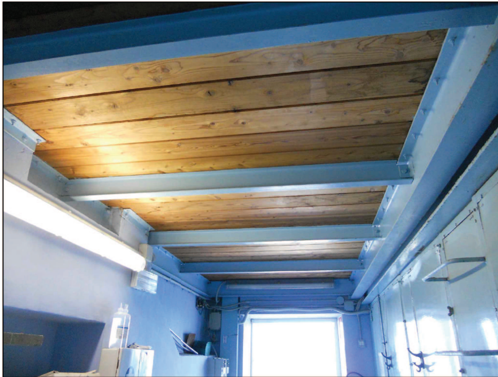
Foto n.17- Interno locale tecnico q:+38,55m
