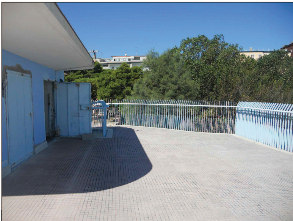
Foto n.32- Locale macchine visto dalla terrazza q:+43,93m
