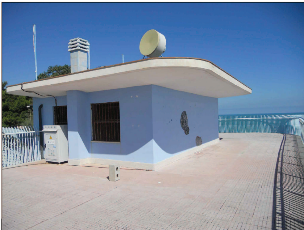
Foto n.30- Locale macchine visto dalla terrazza, lato sud est q:+43,93m
