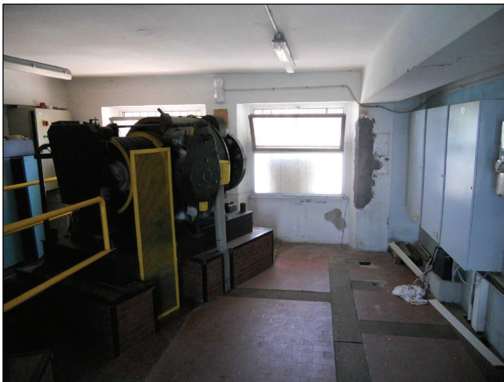
Foto n.37- Interno locale macchine q:+43,93m
