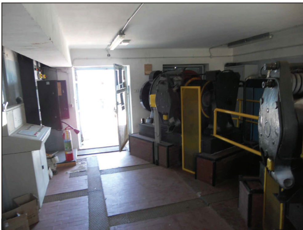
Foto n.38- Interno locale macchine q:+43,93m
