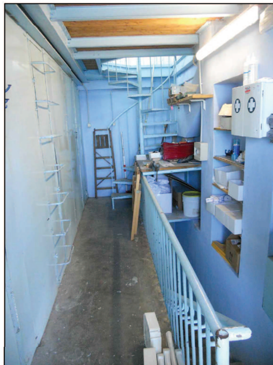
Foto n.18- Interno locale tecnico q:+38,55m
