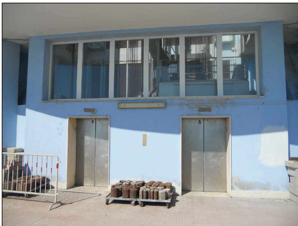
Foto n.39- Blocco ascensori terrazza q:+20,88m
