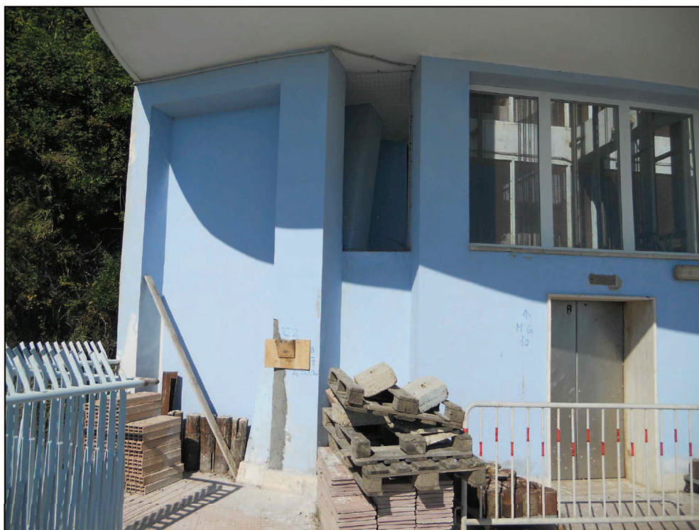
Foto n.40- Blocco ascensori terrazza q:+20,88m
