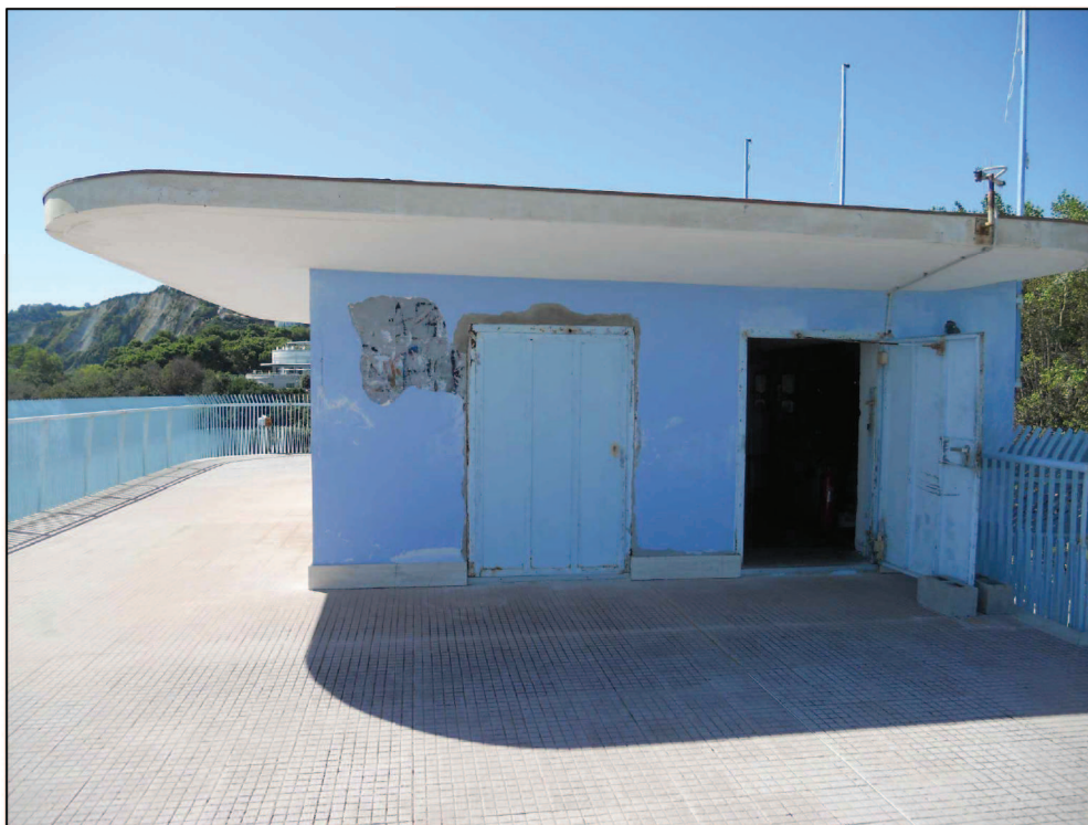
Foto n.31- Locale macchine visto dalla terrazza, lato nord q:+43,93m
