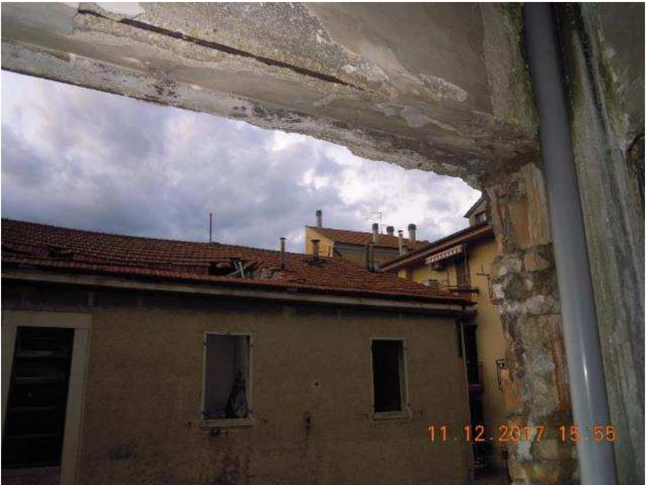
Foto n.16: Copertura sfondata su edificio E2
