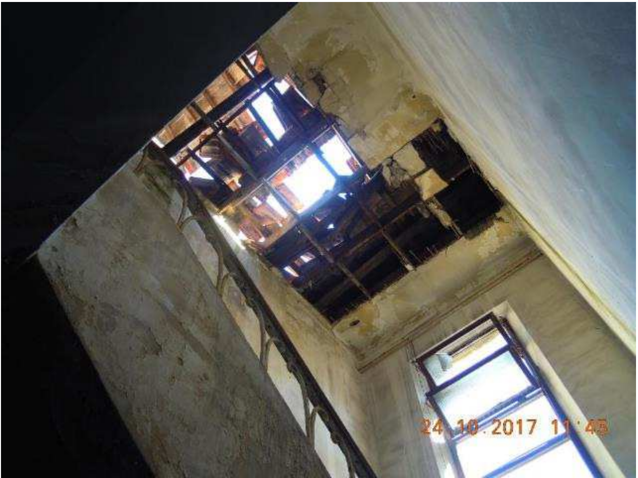
Foto n.17: Copertura sfondata su edificio E2. Dettaglio interno.
