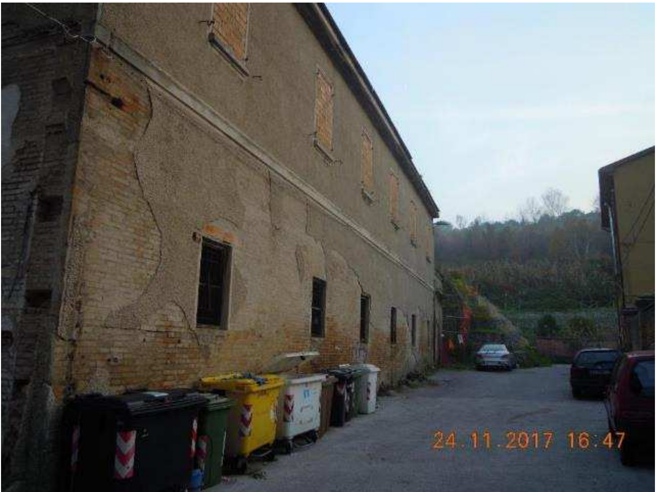
Foto n.22: fronte laterale edificio E2, su strada interna. Cestoni in pietrame e rete a doppia torsione posti sul terrapieno di sfondo.
