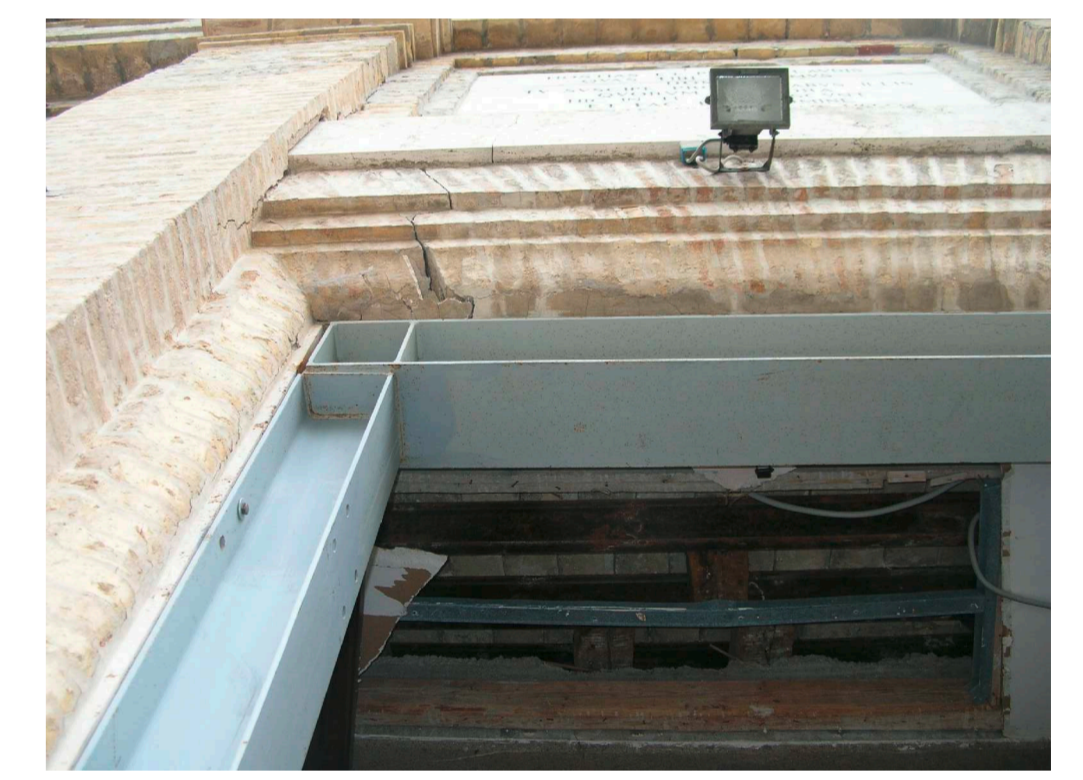
LESIONE SU PIATTABANDA DI INGRESSO
