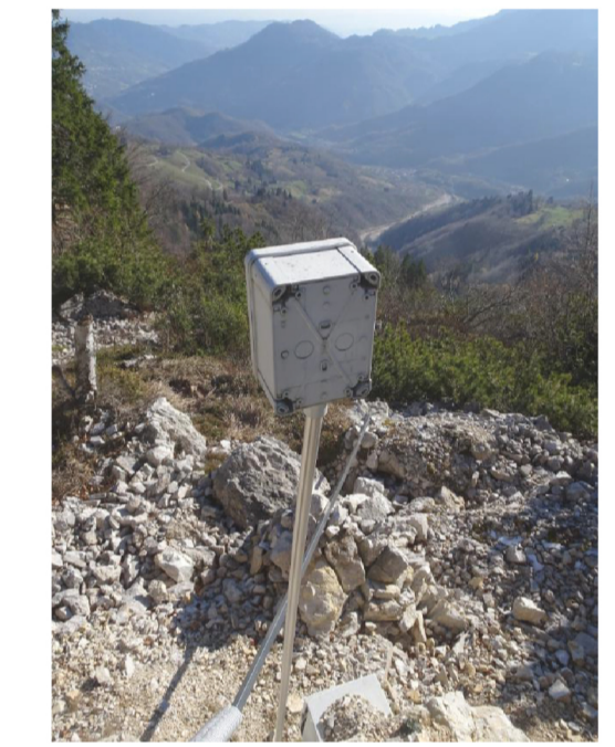
Esempio di utilizzo di moduli radio per trasmissione di misure strumentali.
