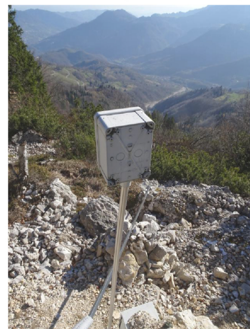
Esempio di utilizzo di moduli radio per trasmissione di misure strumentali.
