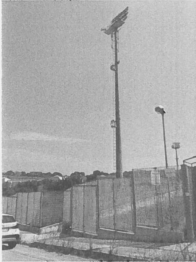
FOTO 1 – Vista d'insieme della stazione radio base
