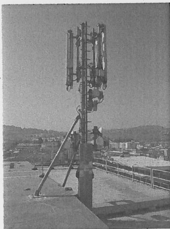
FOTO 4 – Vista della struttura porta antenne e parabole
